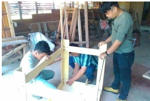
Gambar4. Memperkuat dan mengunci bagian-bagian menggunakan baut dan mur (Foto: Alek Hengki Ziora, 2016)
